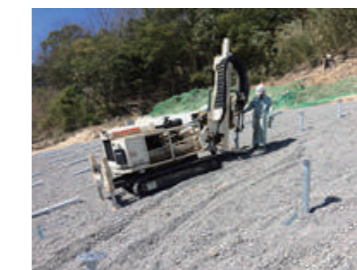
▲ジオロープによる22度ある傾斜地でのスクリュー杭打設
